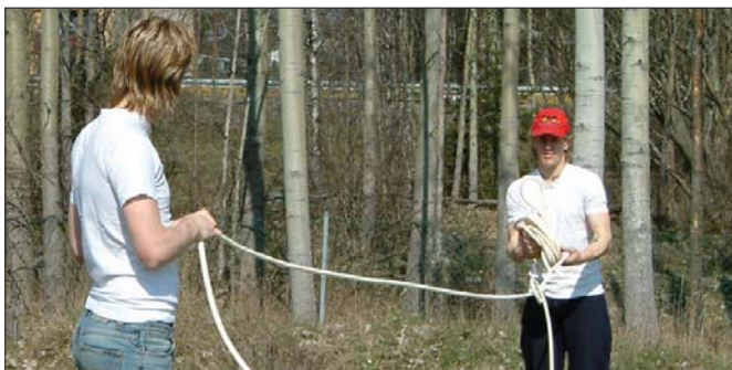
Här ser vi exempelvis hur Brisse och Bille trär kabel. Man kapslade in över 100 meter kabel som sedan skulle jordfästas med hjälp av olika metoder.
